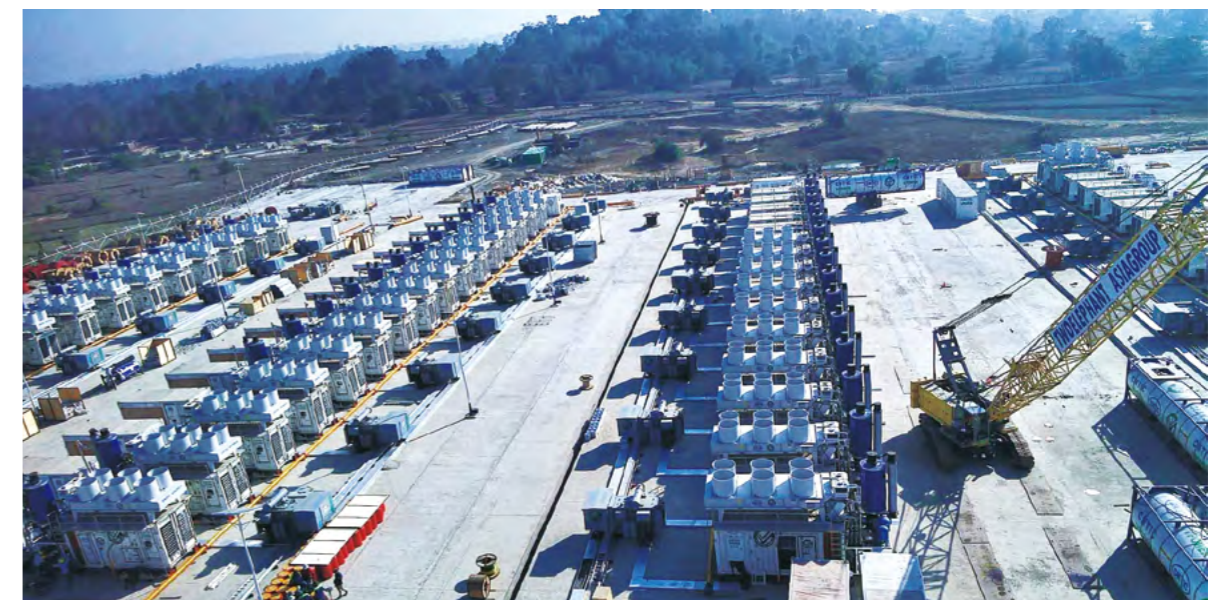
缅甸 LNG 快速发电项目 The LNG Fast Power Generation project in Myanmar
